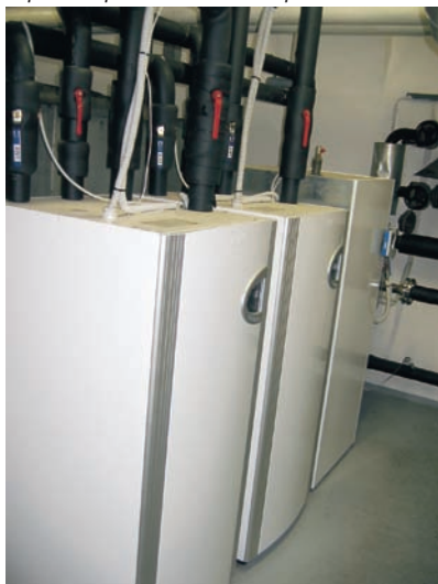
Slika 1 Toplotni črpalki in hranilnik toplote
